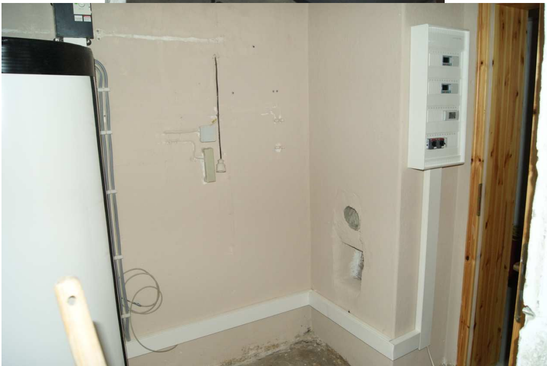
Abb. 5: Warmwasserspeicher und Pufferspeicher (oben) bilden die notwendigen Komponenten im Innenbereich, die Regelung nimmt keinen nennenswerten Platz in Anspruch (unten li, vor Pufferspeicherinstallation)
