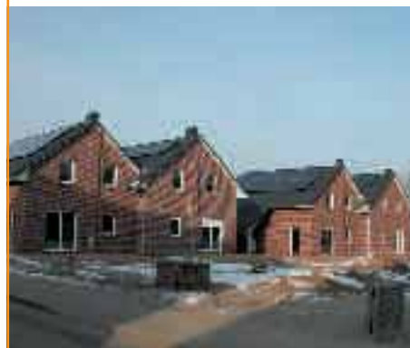
Wohnsiedlung mit Beglau-Wärmepumpen-Direktsystem mit Solarer Stromversorgung
