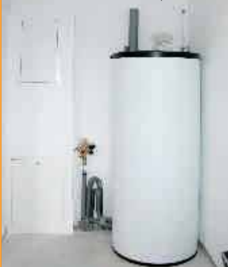
Steuereinheit und Trinkwasserspeicher
